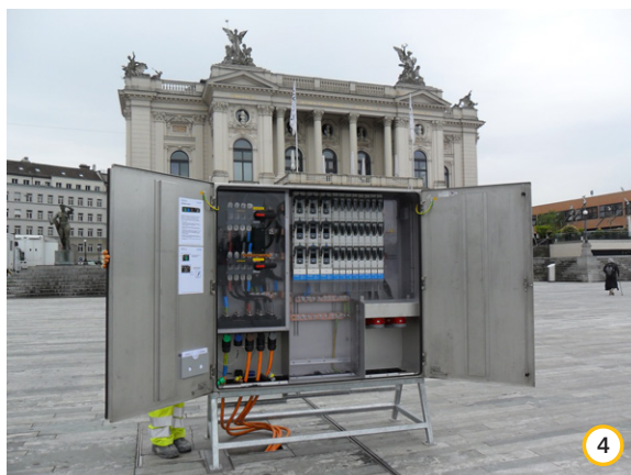
Armoire de répartition GIFAS 800A robuste en acier inoxydable. Alimentation enfichable 2x400A sur PowerSAFE Panelbox. Sorties directes par fusibles basse tension et enfichables CEE 125 + 63A
